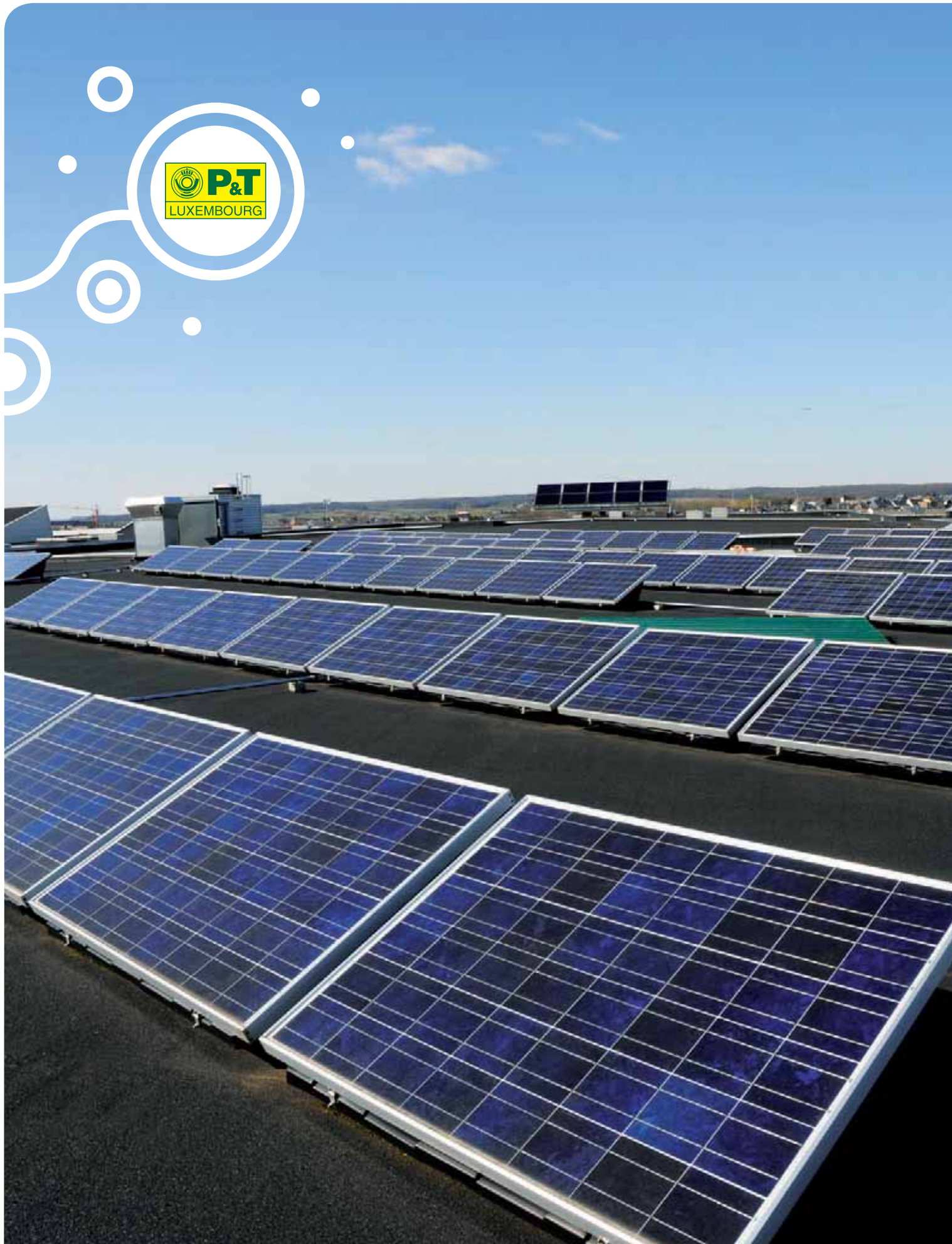
Panneaux solaires sur le toit du Centre de Tri national | Bettembourg
